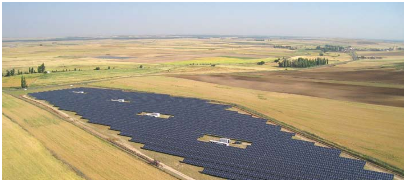
Instalación fotovoltaica en Ávila, España.
